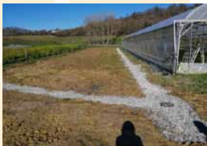
Drain enterré autour des serres au GAEC Petrichor
