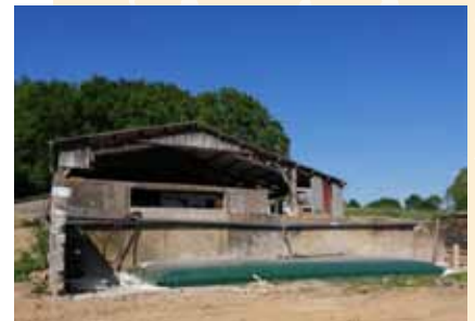
Réserve d'eau connectée à la gouttière du hangar dans une ancienne fosse à fumier
